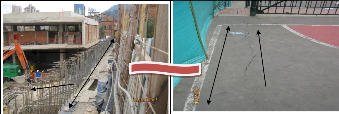
Foto 1: panorámica del muro perimetral. Colegio candelaria institución educativa distrital sede A la concordia, que posiblemente durante su construcción está afectando la estabilidad del parque la concordia.
